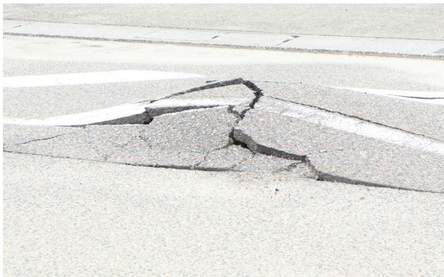
地震で隆起した道路 震災から4ヶ月ほど経過するが七尾市内にはまだ爪痕が残る
